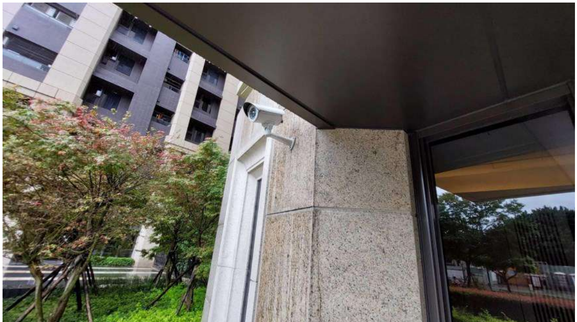
既有監視系統部分 - 大門出入口及各重點位置全天候監視監控
