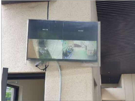
進入社區車道處之同步顯示器
